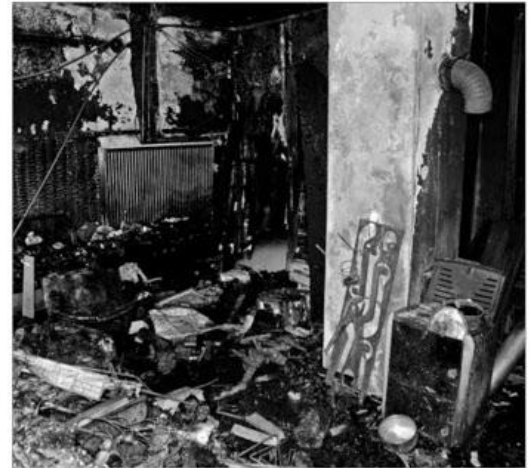
Kein Entrinnen: Beim Brand seiner Kellerwohnung erlitt der Mann tödliche Rauchvergiftungen.
