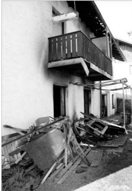
Brandherd: Das Feuer war im Keller ausgebrochen und hatte sich über den Balkon ins Erd- und Dachgeschoss ausgebreitet. Gesamtschaden: 100 000 Euro. – Fotos: Windpassinger
